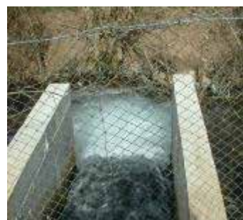
Ispust vode, zaštićen paravanom protiv vidre
